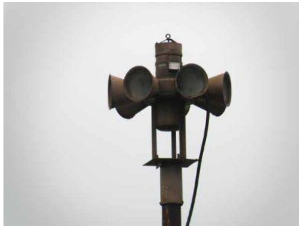
Image. Tsunami warning siren 13
